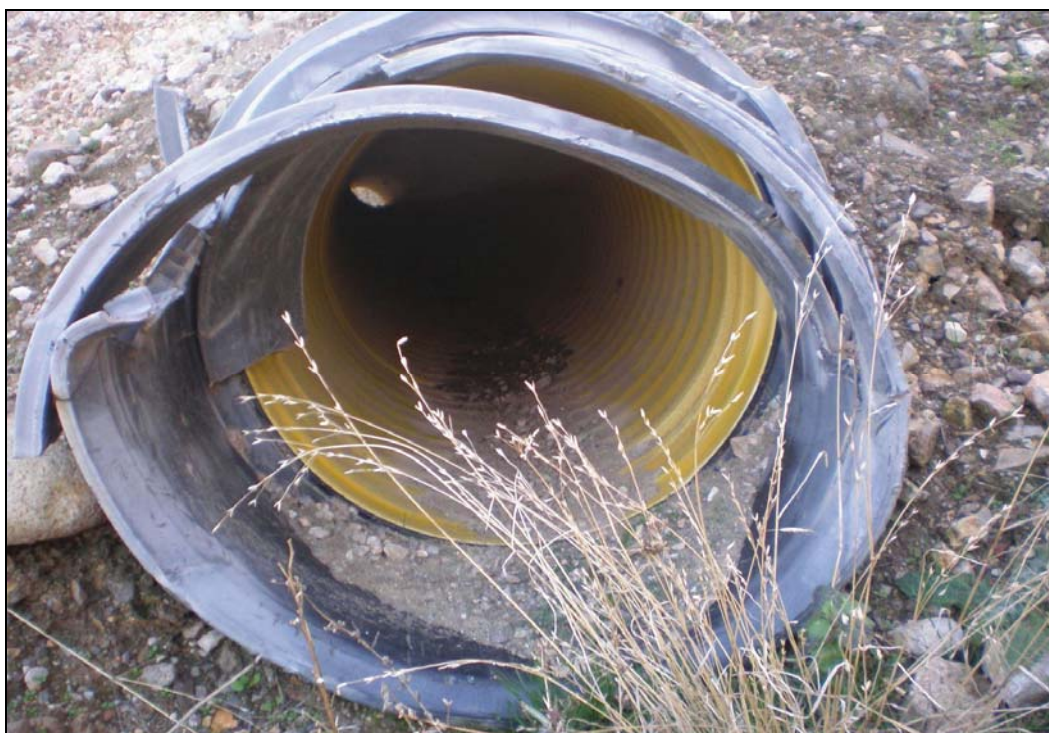
Снимка № 5: Проход за дребни животни под жсп линията при Лот 2, км 210+000 в дясно по посока Свиленград. Входът на тръбата е разрушен
