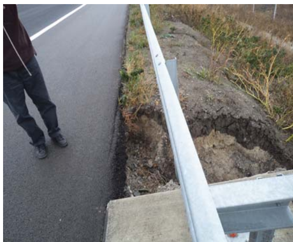
Овражна ерозия при моста на р. Азмак. Вижда се укрепителния слой на насипа. ЛОТ 2 на АМ „Тракия” Снимка № 32
