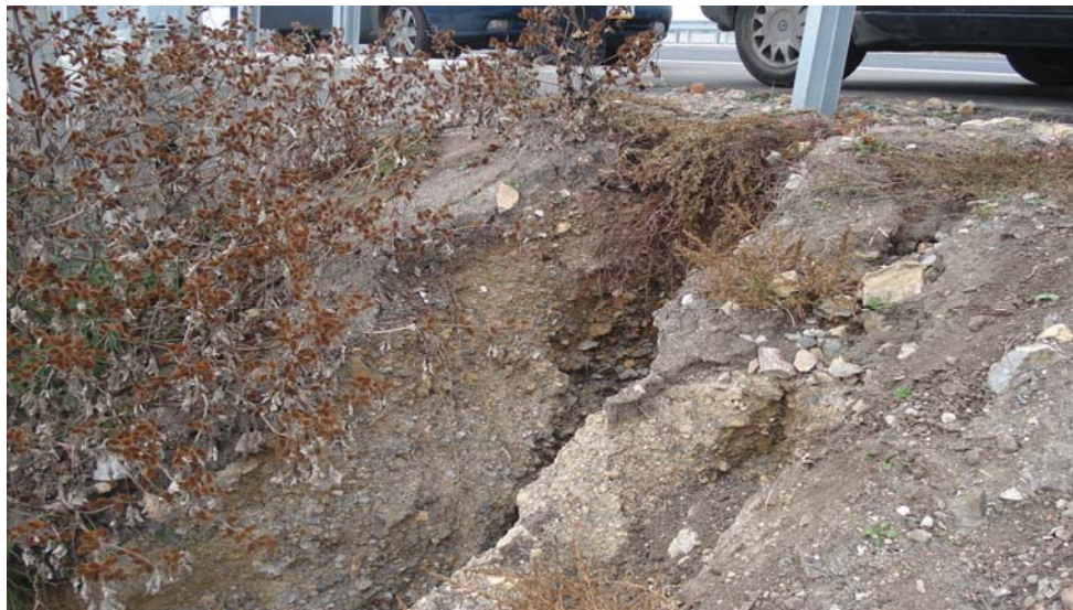
Снимка № 20: Подкопаване на пътното платно вследствие ерозия на ската
