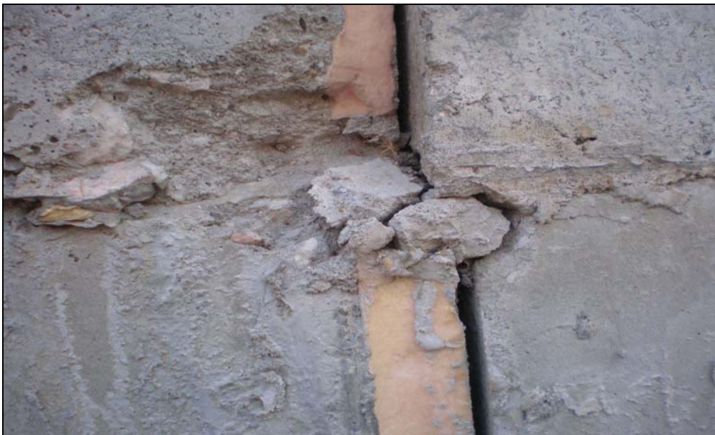
Снимка № 12: Шумозащитен екран в края на Лот 1 при гара Първомай – състояние на фуга в бетоновата стена на шумозащитния екран
