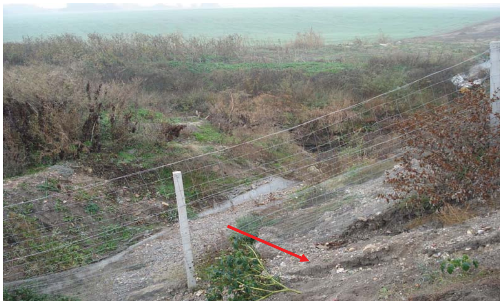
Снимка № 21: Подкопаване на оградната мрежа вследствие ерозия
