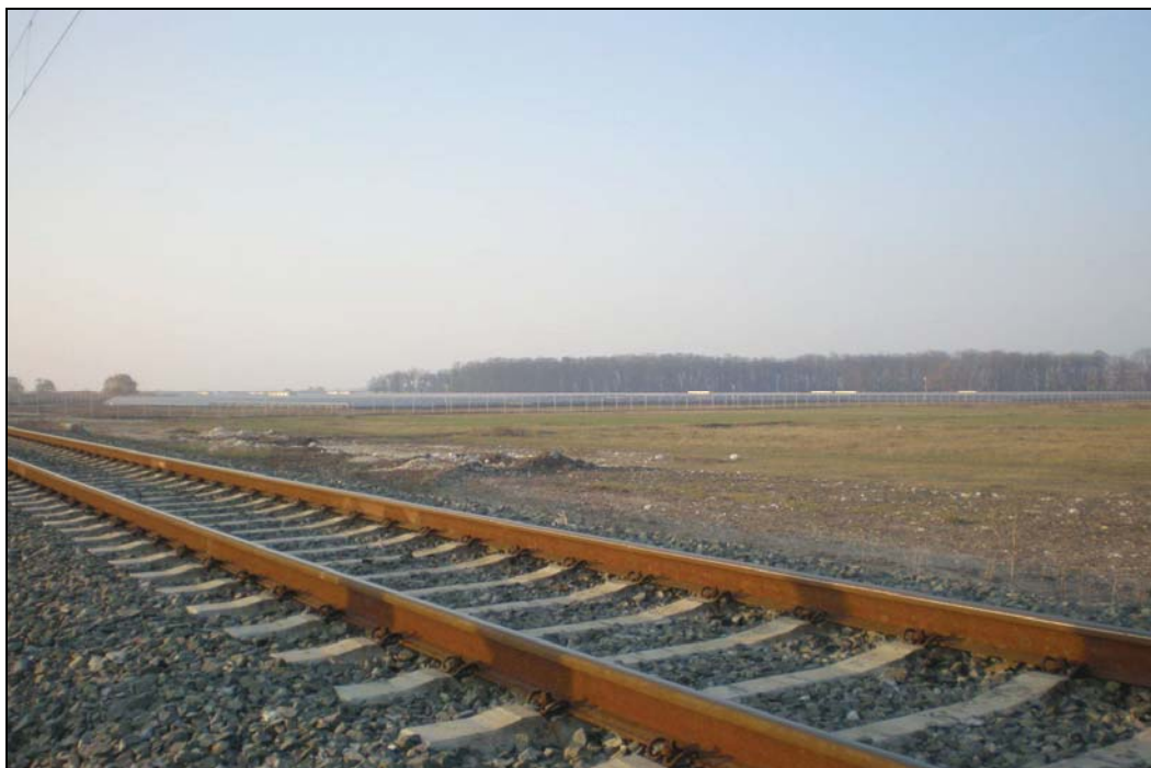
Снимка № 6: Общ вид при Лот 2, км 209+800 в посока Пловдив. На заден план се вижда голям фотоволтаичен парк, построен след изграждане на жсп линията
