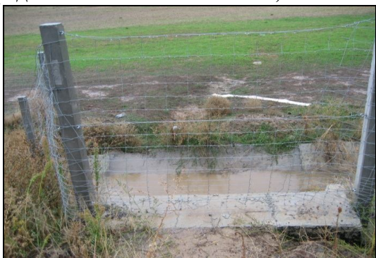
Сн. 16. Заводнен водосток и канавки
