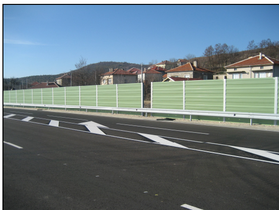
Сн. 12 Нарушение в целостта на екрана
