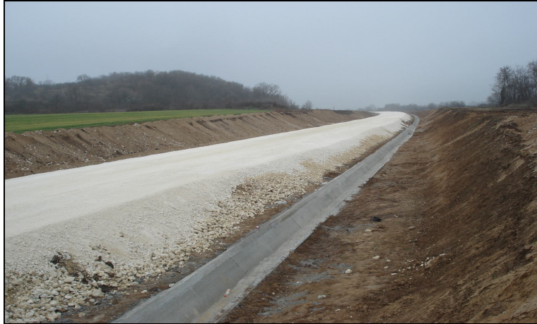
Сн. 6 Открити, дълбоки канавки до насипа на жп линията
