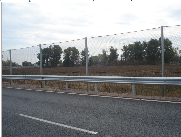
Сн.6 Оградни мрежи за птици в участъка на АМ „Хемус“, при влажните зони на Долни Богоров
