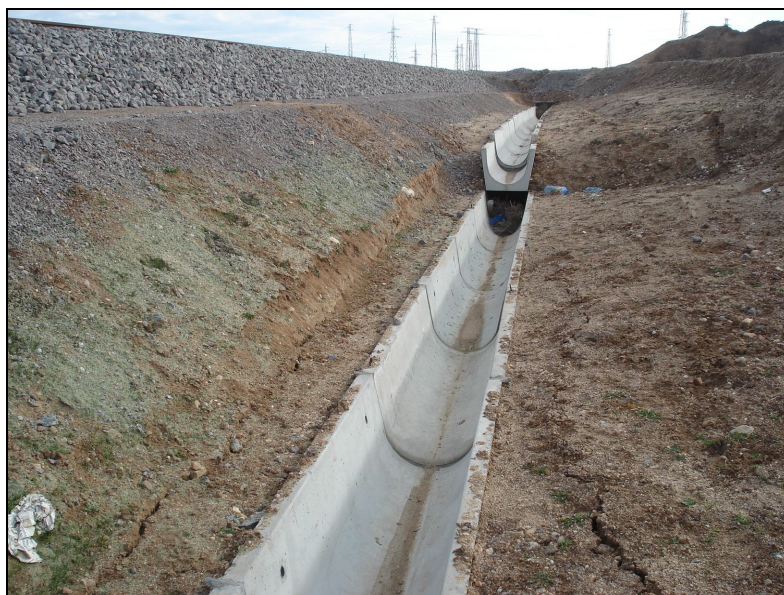
Сн. 12 Открити, дълбоки канавки с отвесни стени до насипа на жп линията
