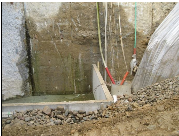
Сн. 2 Водопонизителна система МС 21 „Дружба”
