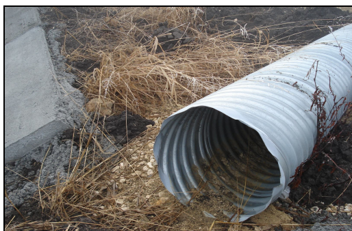
Сн. 1. Гофрирана, метална тръба.
