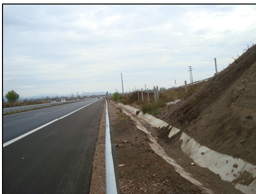
Сн.3 Ерозирани откоси и запушени канавки
