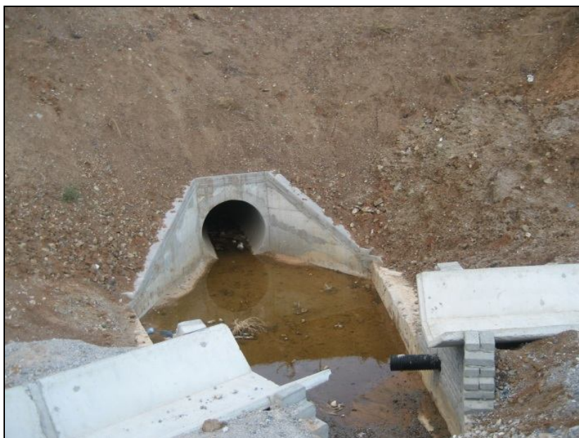
Сн. 9. „Предстоящо” запълване на потока към водостока от насипа
